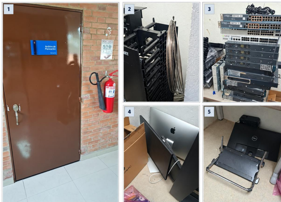
Evidencia fotográfica 8. cuarto técnico TI, sede Calle 100
