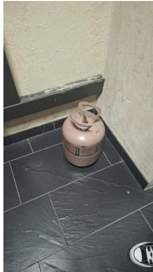
Evidencia fotográfica 3. Cilindro almacenado directamente sobre el piso en el cuarto técnico Sede Campus Nueva Granada.
