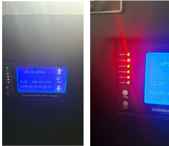
Evidencia fotográfica 9. Ups del cuarto técnico de la sede Facultad de Medicina y Ciencias de la Salud operando en modo bypass
