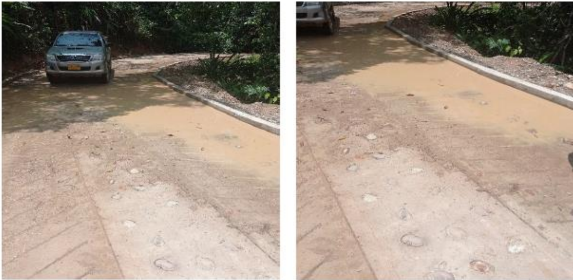
Imagen 1. Empozamiento de agua por falla técnica. Fuente: Comunicado No 2022ee0086220 CGR
