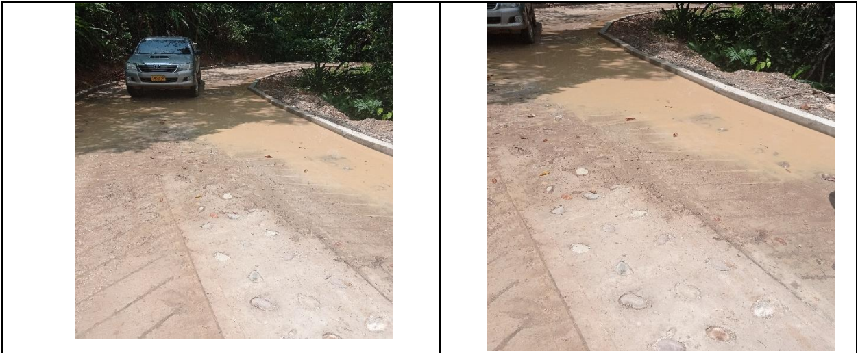
Empozamiento de agua por falla técnica.
