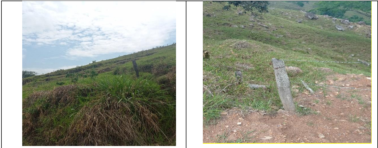
Foto falla geológica del terreno, inestabilidad de taludes.
