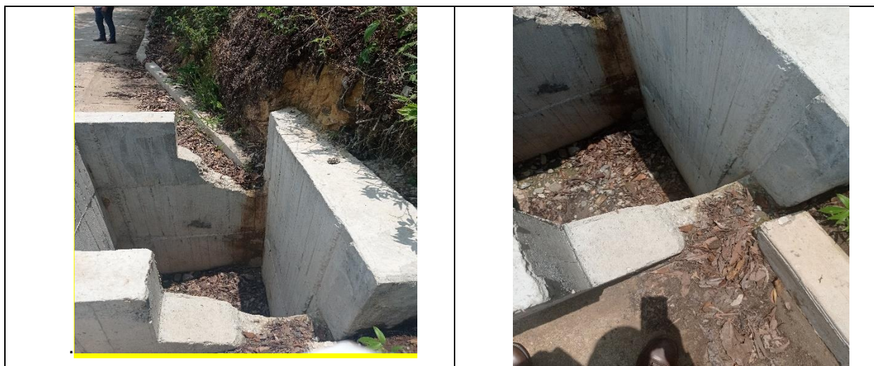
Cuadro 2. Cuantificación por daño en alcantarilla:
