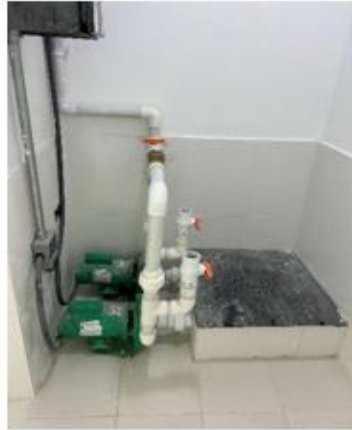
Cuarto de bombas
